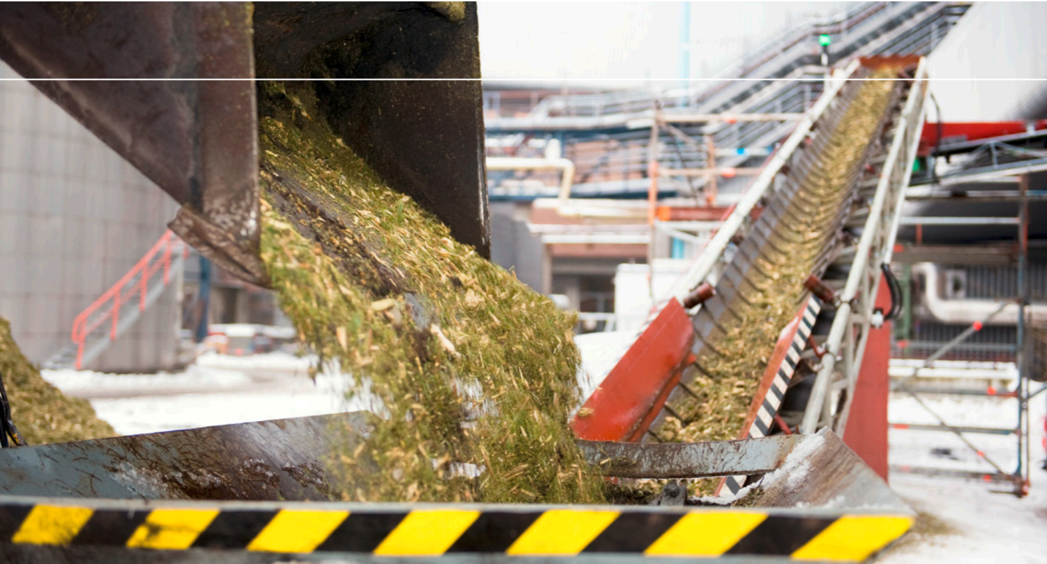
Transport von Holz hackschnitzeln in das Heizkraftwerk
