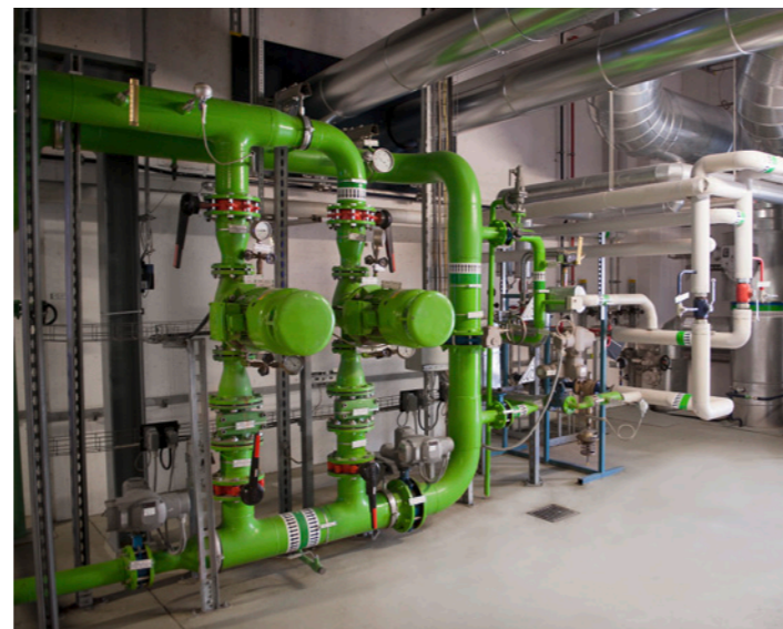
In der Kältezentrale am Potsdamer Platz verwandeln wir Wärme in Kälte.
